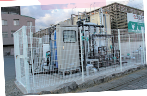
地下水活用システム
